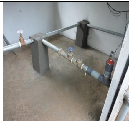
INTERIOR CASETA MAQUINAS
