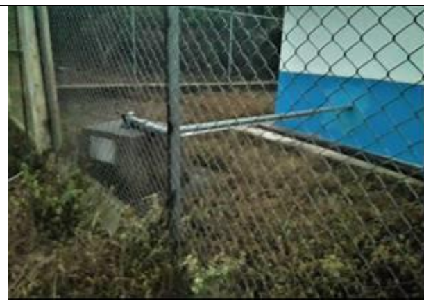
POZO DE EXTRACCION DE AGUA
