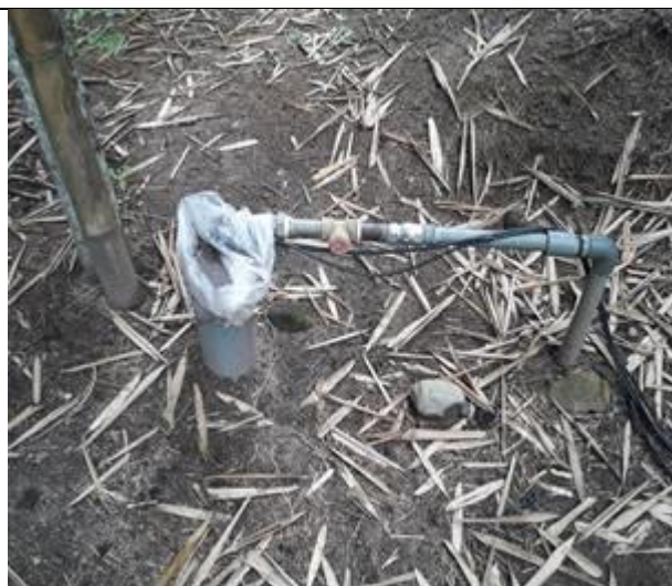
POZO DE EXTRACCION DE AGUA
