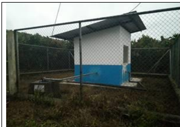
CASETA DE MAQUINAS
