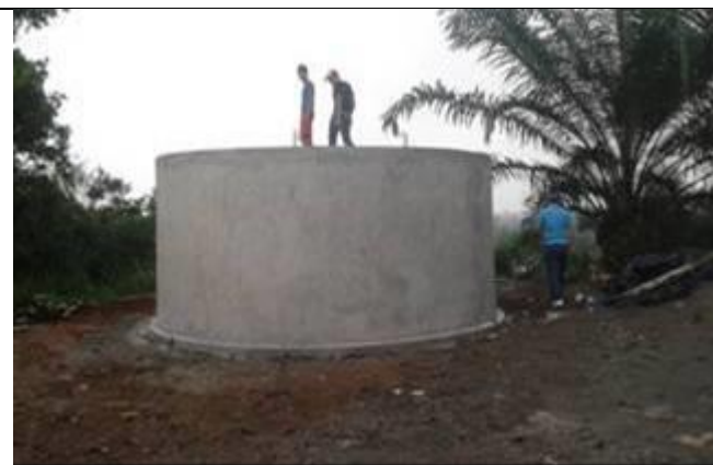
TANQUE DE DISTRIBUCION CONSTRUIDO EN LA PARTE ALTA DEL RECINTO
